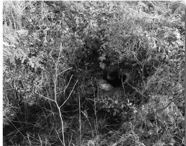
Photo 6 : Un ponceau dégradé sur le parcours forestier du ru (des pierres de l'ouvrage sont tombées, elles obstruent partiellement la sortie de la buse) (photo prise, le 2 février 2014).
